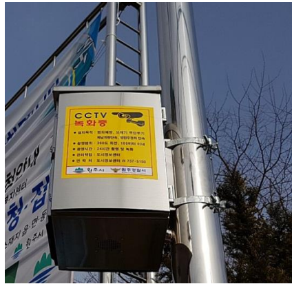
외부에 노출된 CCTV
