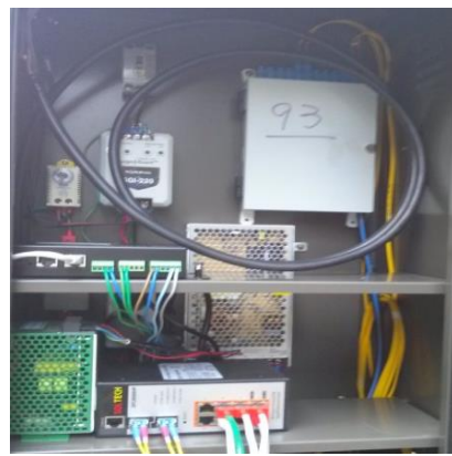
함체 내부에 설치된 스위치 장비
